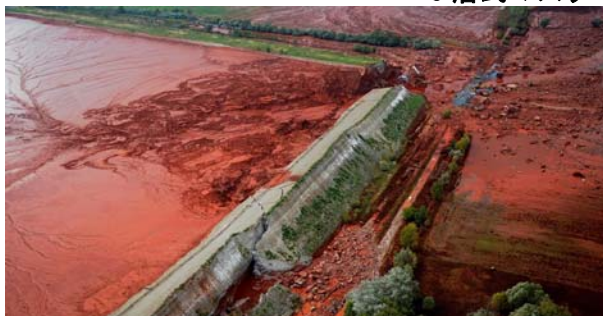
(堤防が決壊した廃液貯蔵池)
